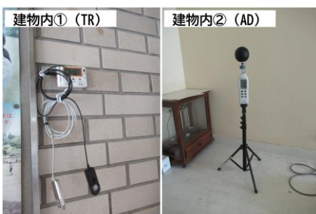
図4 建物内への設置の様子
